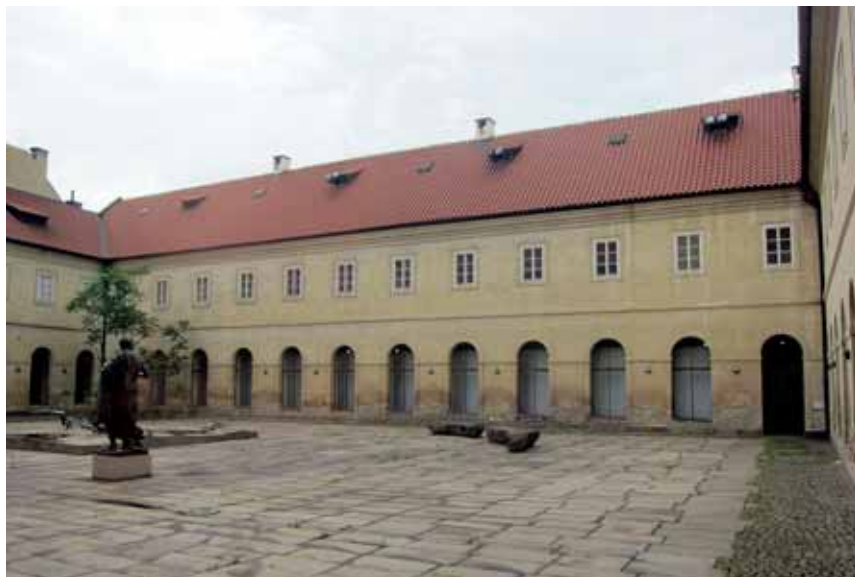
Obr. 29. Cirkulace vzduchu na velkém uzavřeném nádvoří nezpůsobuje díky vlivu poměru jeho šířky k výšce tak rozsáhlá poškození jako v případě malých uzavřených nádvoří. I v těchto případech je nutné, jako jeden z podkladů pro úspěch rekonstrukce, dokumentovat všechny stopy způsobené cirkulací vzduchu. (Foto Milan Jančo, 2011)
