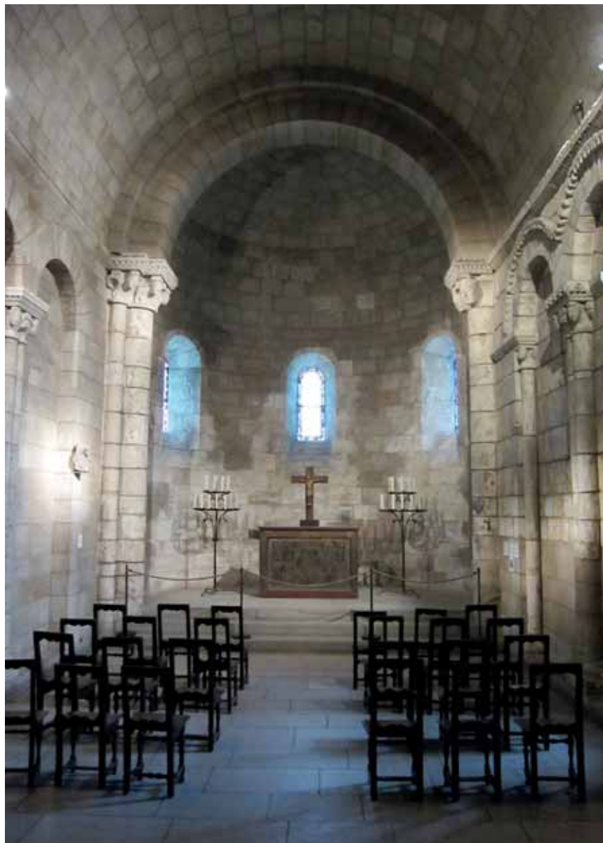
Obr. 30. V jarních měsících, kdy ještě nejsou zdi a dlažba kamenných staveb přirozenou cestou prohřáté, dochází při větrání na jejich povrchu ke kondenzaci atmosférické venkovní vlhkosti. (Foto Milan Jančo, 2011)
