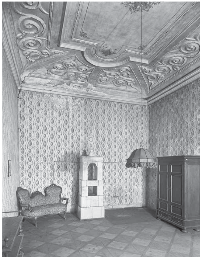
Obr. 35. Doudleby nad Orlicí (okres Rychnov nad Kněžnou), zámek, sál s bílými kamny. Průnik vlhkosti z možného zatékání. Lehčí vlhký vzduch nahoře nepodporuje v nevytápěné místnosti odpar této vlhkosti. (Foto Čestmír Šíla, 1950)
