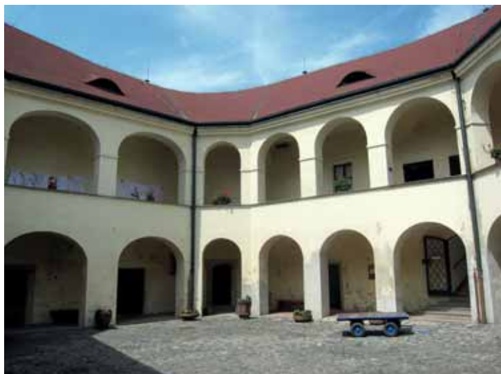
Obr. 26, 27. Poškození na osluněném úpatí severního traktu nádvoří je typické pro malá uzavřená nádvoří. Před zahájením obnovy je nutné dokumentovat stopy po poškození způsobené cirkulací vzduchu a jejich rozsahu přizpůsobit zvolený způsob povrchového ošetření fasád. I když je fasáda památkového objektu nově obnovená, nelze v těch samých místech zabránit jejímu opakovanému poškození, k tomu dochází působením stálé cirkulace vzduchu. (Foto Vladimír Fyman 1956; Milan Jančo, 2011)
